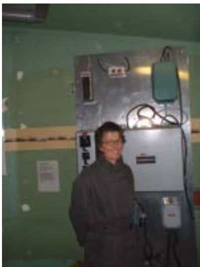
Lena Arén i "halvfärdig" minstation
