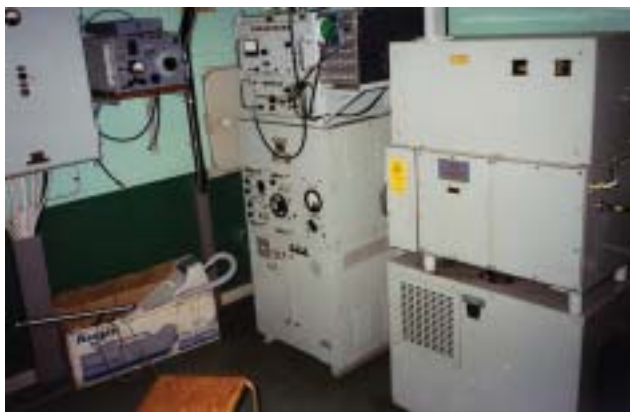
Radarrummet, teknikernas arbetsplats
