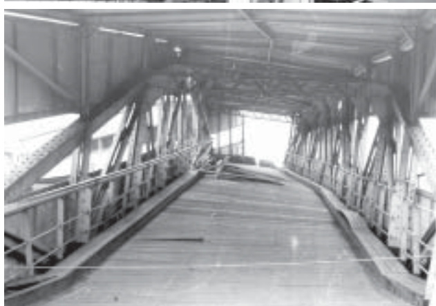
Två bilder som visar den sönderkörda Überseelbrücke. Foto författaren
