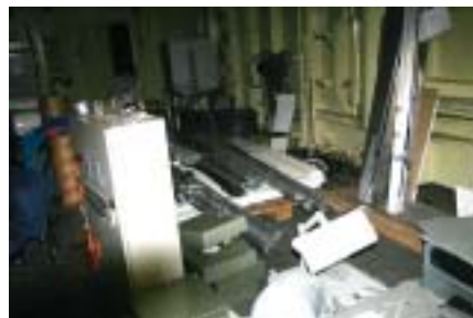
Fartygets nedmonterade datacentral. Foto Olle Melin
